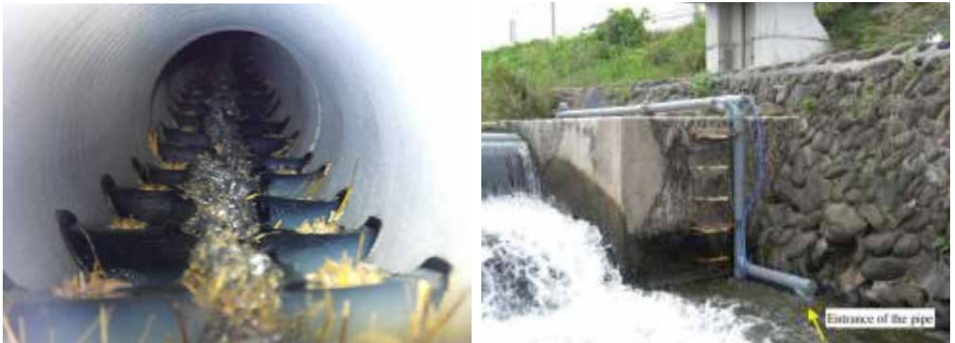
Figura 14 - Tubulatură pentru pești, (stânga - prin tuburi existente, dreapta - tubație nouă)
